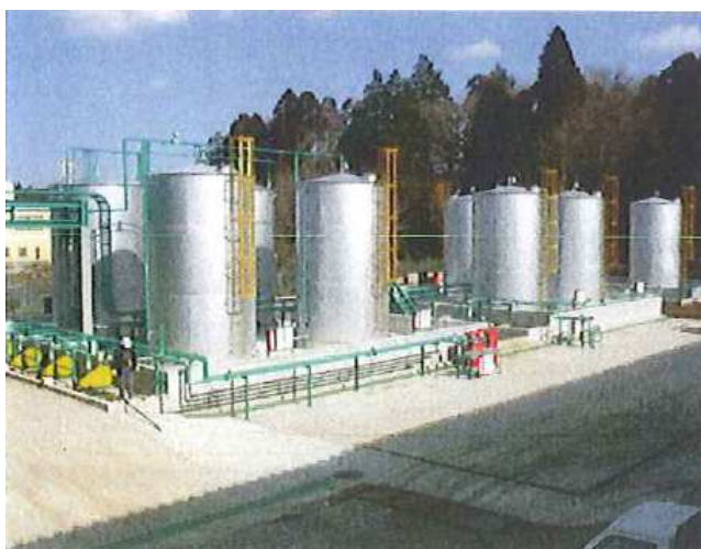
屋外貯蔵タンク
